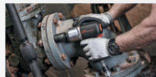
Mantenimiento de instalaciones
