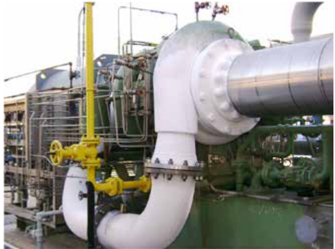
3MSG-5G Propane Compressor
